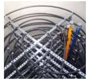
Entzugswärmetauscher im Eisspeicher
