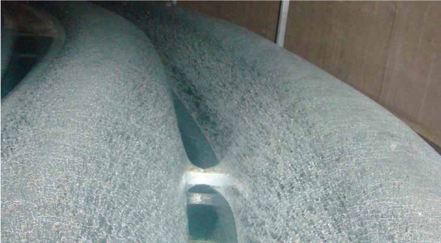
Eisbildung um den Wärmeübertrager im SolarEis-Speicher.
